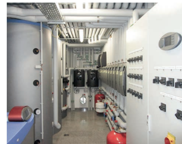
Sauber ausgeführter Heizraum mit HARREITHER-Technologie: Universum® Komfortmanagement, Speicher, Wärmepumpe, Pumpengruppen und Hisan®-Verrohrung.
